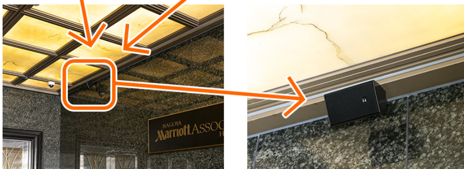
1階エントランスに設置されたコンパクトスピーカー Fシリーズ。 空間に調和するデザインで、ホテル内のWi-Fi経由でBGM音源が流れ、 マリオットホテルの世界観の演出に一役買っている。
