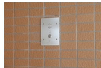
玄関に設置されたIPドア端末 N-8540DS 。 ボタンを押すと職員室と通話できます。来校者からの連絡に活用されています。
