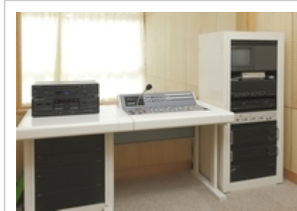
放送室に設置された校内放送設備のデスク型放送設備。パケットインターカムシステムのマルチインターフェイスユニット N-8000MI が接続されており、教室の非常用ボタンが押されると連動して緊急メッセージが放送されます。
