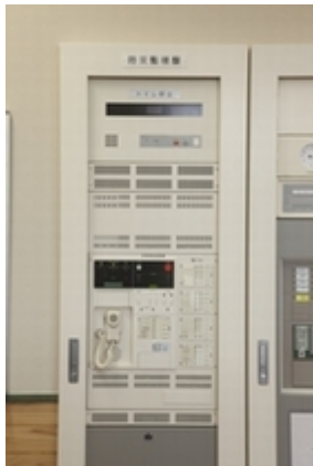
職員室に設置された非常用放送設備。
