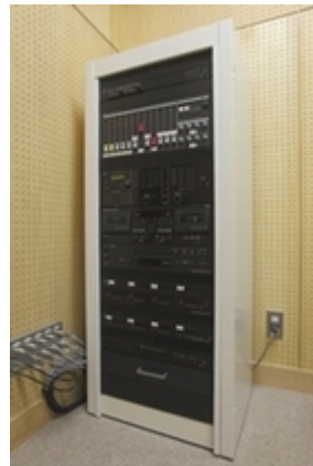
体育館放送室に設置された体育館放送設備。地域開放にも活用されています。
