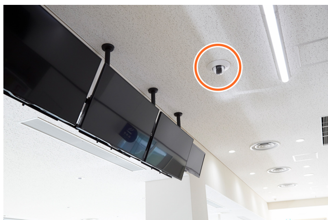
メインスタンド棟内に設置されたネットワークカメラ
