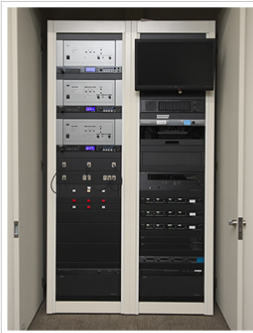
委員会室にある制御機器架, 赤外線会議システムTS-800シリーズのセンター装置3台が設置されている。
