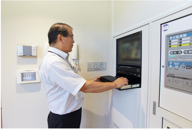
PTZカメラの向きを変えて館内の様子を確認
