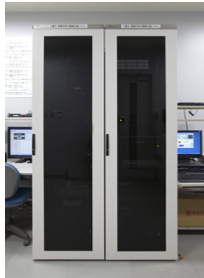
放送機器架。 IP告知送信機や自動放送制御機などが収納されています。
