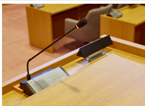
議長席にある議長ユニットTS-911。ユニットが動かないように、固定用の木枠が設置されている。
