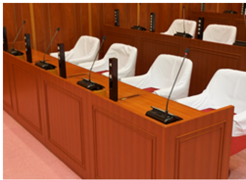
執行部席には赤外線会議システムの参加者ユニットTS-902が1台ずつ設置されている。
